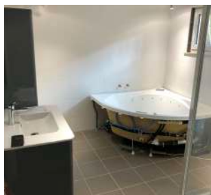
Bagno installato nel seminterrato
