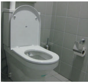
Wc installato nel seminterrato
