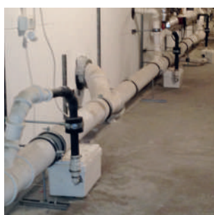
Sanishower Flat installato nel locale tecnico dietro i bagni
